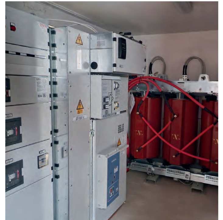
CABINA ELETTRICA MEDIA TENSIONE
